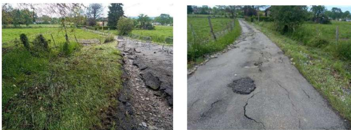
Figure 41 : Dégâts suite aux phénomènes de ruissellement et de ravinement sur la commune d'Ardiège suite à l'orage du 4 mai 2025
