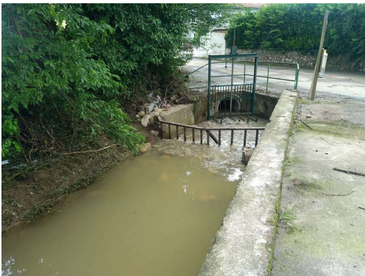
Figure 8 : Photo des dépôts dans le piège à embâcles en amont de la buse
