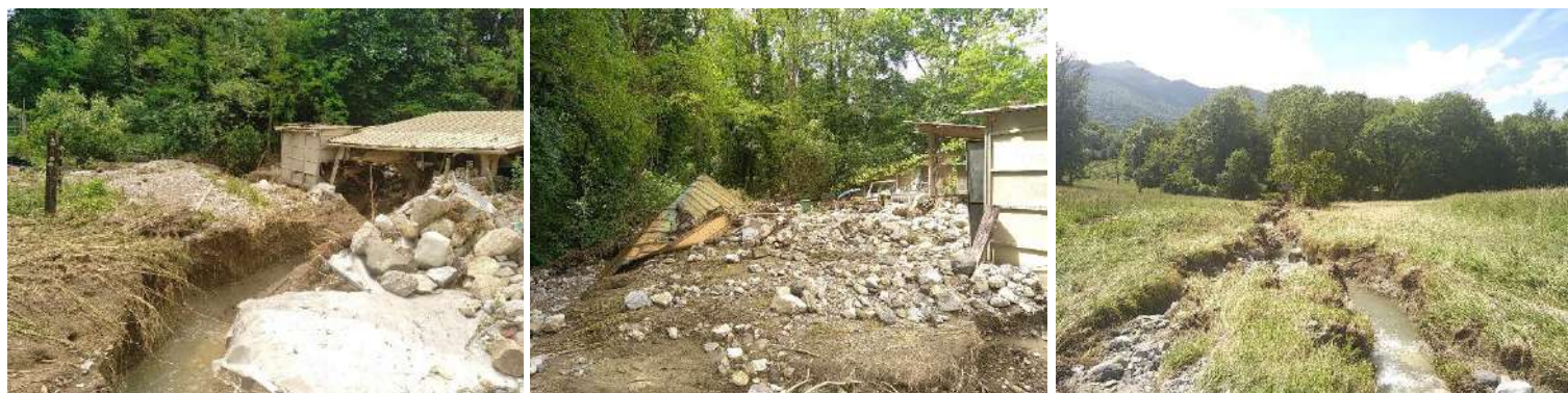
Figure 17: Photographies des dégâts recensés sur la commune de Lourde
