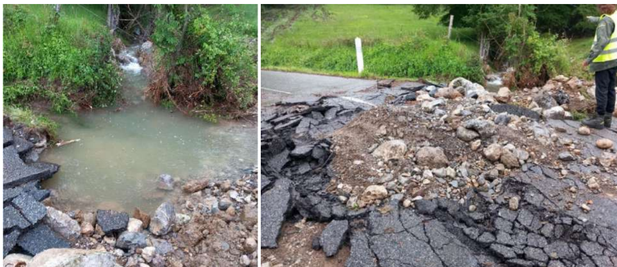
Figure 19: Photographies du colmatage du passage busé sous la RD9a par les matériaux transportés par l'Arrieu Sec et dégâts causés sur la chaussée (crédit photos : RTM)
