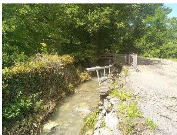
Figure 20: Photographie des dégâts causés sur le mur de soutènement de la voirie suite aux fortes précipitations du 24 mai 2023 sur la commune de Sauveterre-de-Comminges (Boucou)
