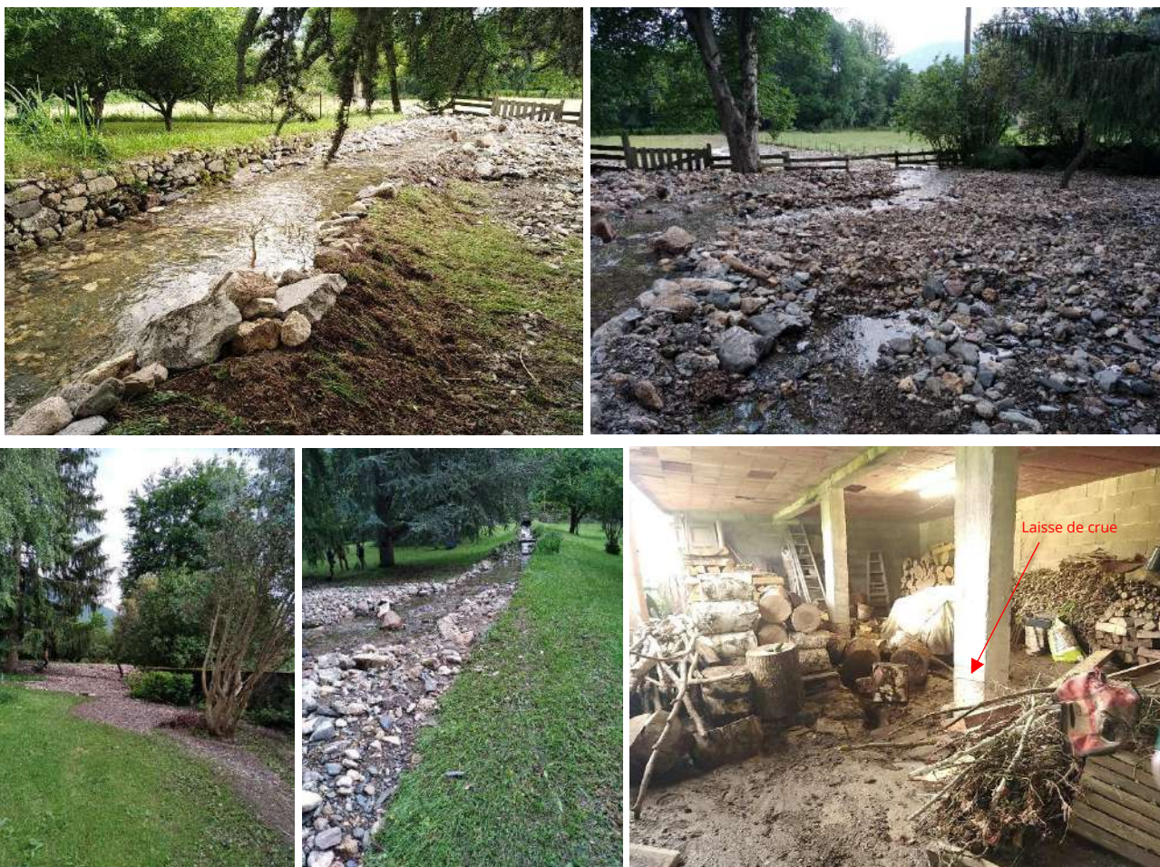
Figure 13: Dépôts de matériaux et laisses de crues en rive droite du ruisseau d'Antichan au droit d'une propriété privée sur la commune d'Ore
