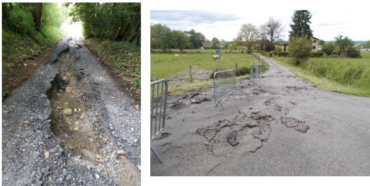
Figure 10 : Planche photographique des dégâts observés sur la commune d'Ardiège
