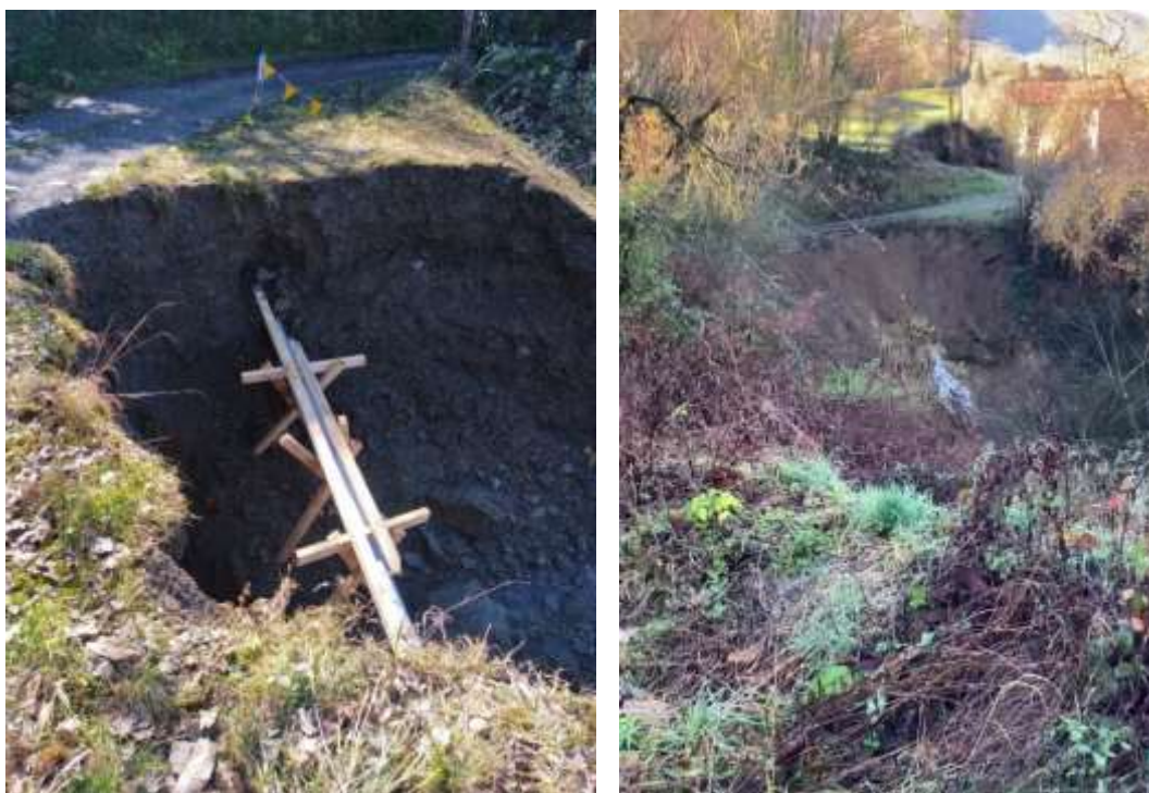
Figure 35 : Réseau d'assainissement et route détruits par des glissements de terrain lié à la réactivation de résurgences sur la commune de Juzet-d'Izaut
