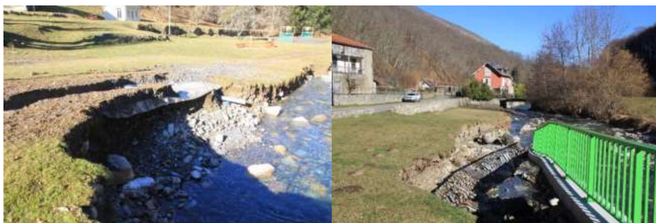
Figure 30 : Dégâts constatés en rive gauche de l'Ourse de Ferrère sur la commune de Ferrère.
