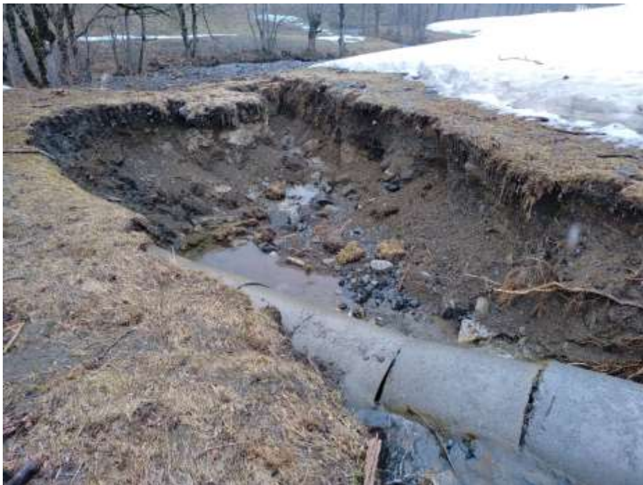
Figure 27 : Dégâts constatés sur le Ruisseau d'Arrechaudède, affluent rive droite de la Neste d'Oueil sur la commune de Cirès
