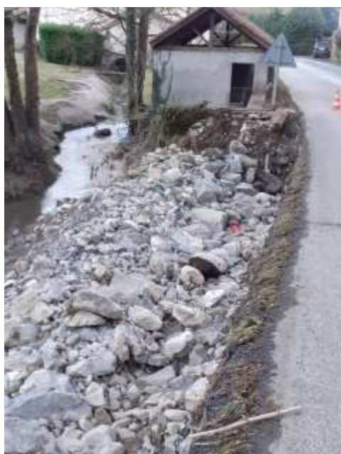
Figure 33 : Dégâts au droit de la voirie départementale en rive gauche de l'Ourse sur la commune de Gembrie
